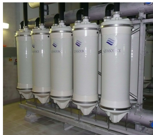
Modules de filtration membranaire
