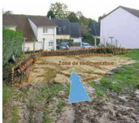
Figure 8 : Entre deux champs ou à l'amont d'une zone urbanisée, les fascines permettent de ralentir les écoulements et de retenir les matières charriées par les flots, limitant ainsi les coulées d'eau boueuse. Photo d'origine : AREAS.
