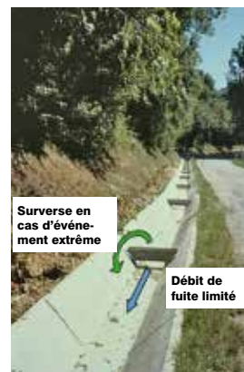
Figure 9 : Fossé avec limiteurs de débit, mais permettant l'écoulement des eaux en surplus en cas d'événement extrême. Photo d'origine : Yves Nédélec.
