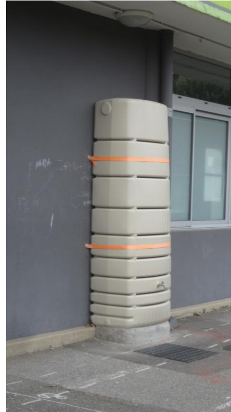
Citerne de récupération
