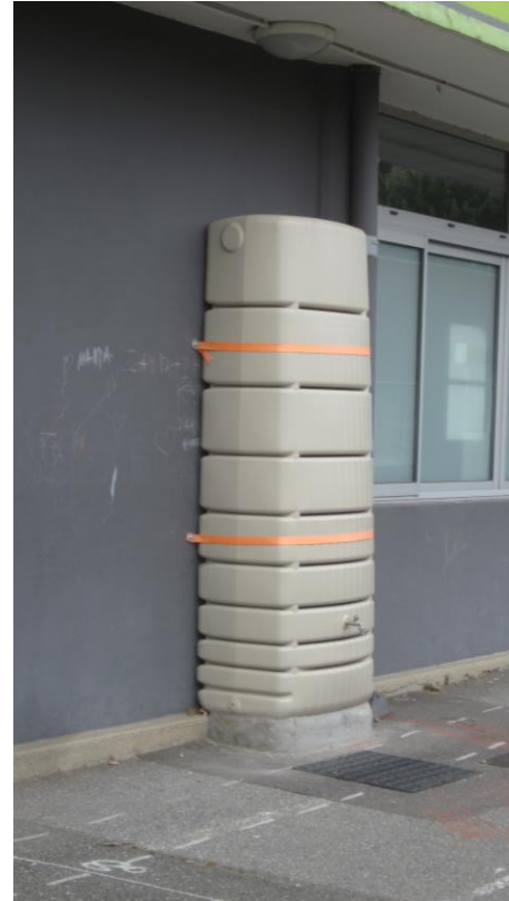
Citerne de récupération
