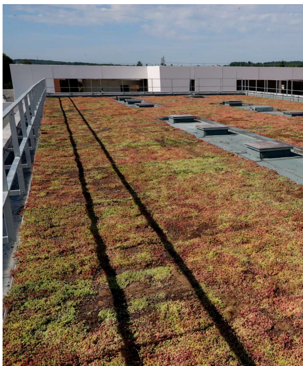
Toiture stockante / végétalisée
