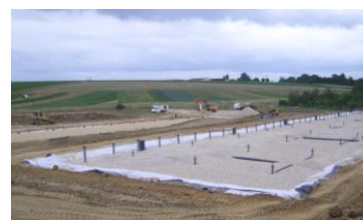
Filtre planté de roseaux en été
