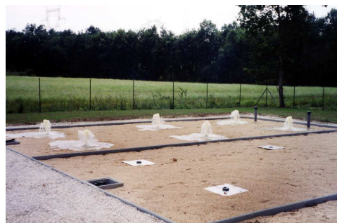
Filtres à sable de Forges (110 EH)
