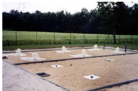
Filtres à sable - Forges (110 EH)
