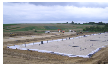
Filtre planté de roseaux en été
