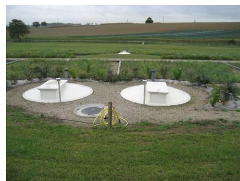
Filtre planté de roseaux Chambry (1 200 EH)
