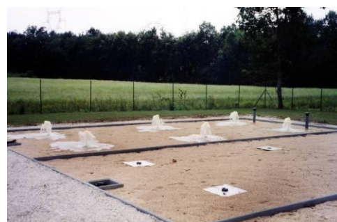
Filtres à sable - Forges (110 EH)
