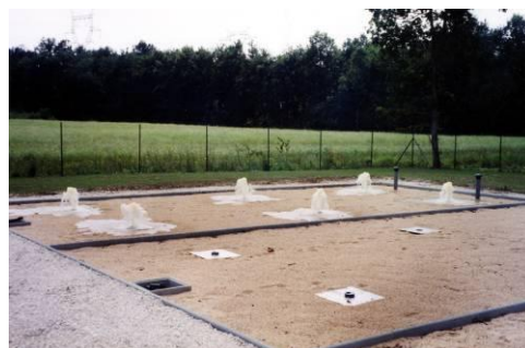
Filtres à sable - Forges (110 EH)
