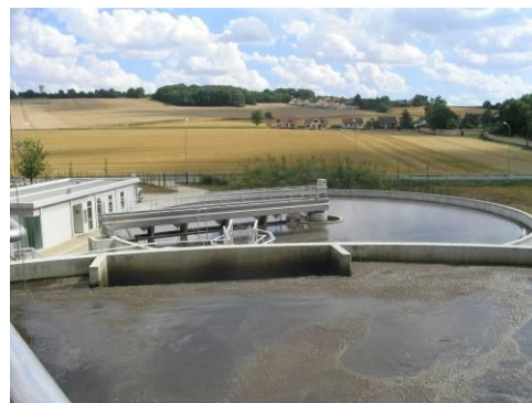
Boues activées Provins (23 330 EH)
