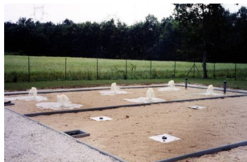
Filtres à sable - Forges (110 EH)
