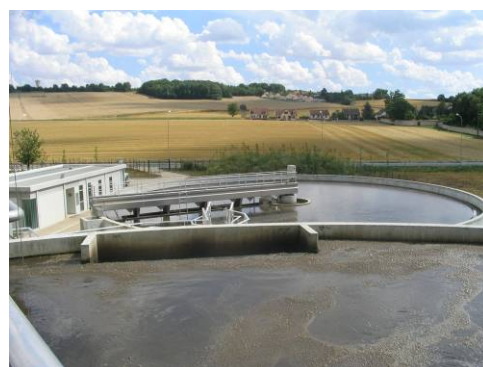
Boues activées Provins (23 330 EH)
