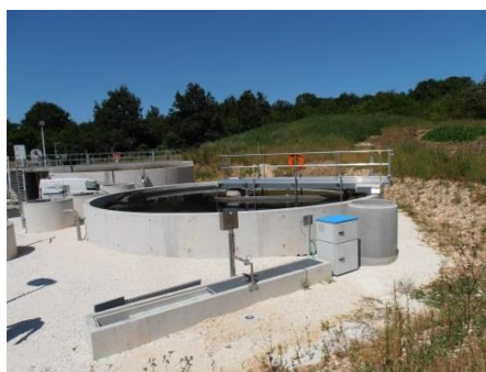
Station d'épuration de Solers (2012) Capacité épuratoire de 1 800 EH
