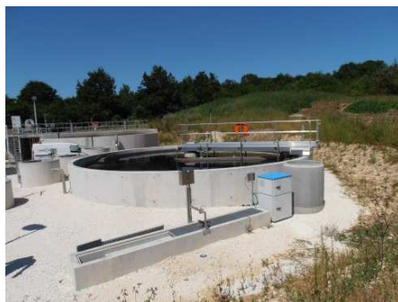
Station d'épuration de Solers (2012) Capacité épuratoire de 1 800 EH
