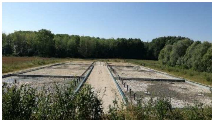
Station d'épuration de Châtenay-sur-Seine (Filtres plantés de roseaux – 1050 Equivalents-Habitants)
