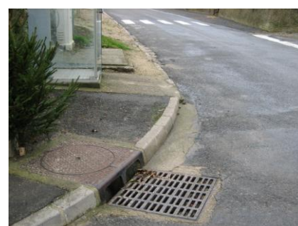
Avaloir eaux pluviales Fort risque de pollution des eaux
