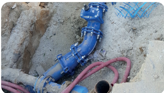
Patrimoine réseaux eau potable
