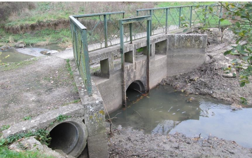
Ancienne vanne et ouvrage transversal de l'étang aval à enlever 25 novembre 2014
